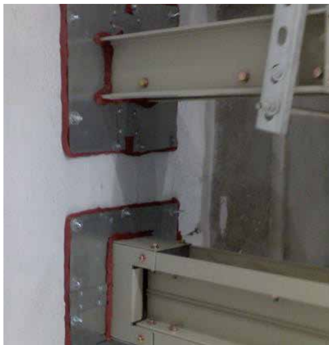
Nueva sede edificio Bancolombia. Medellín- Antioquia 2009 "Sellos cortafuego instalados en tuberías del sistema de red contra incendio, tuberías de aire acondicionado y elementos de transmisión de energía eléctrica.
