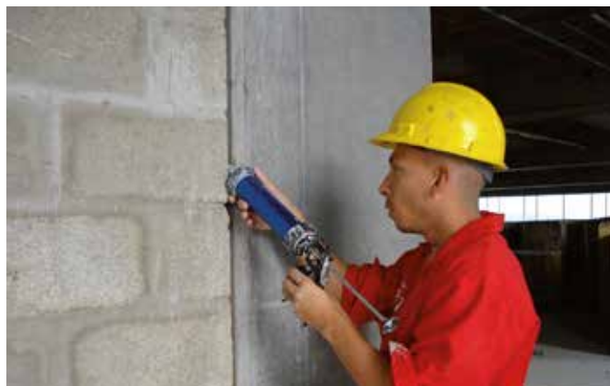
Nueva sede edificio Bancolombia. Medellín- Antioquia 2009 "Aplicación de silicona cortafuego en todas las juntas de dilatación de la mampostería".
