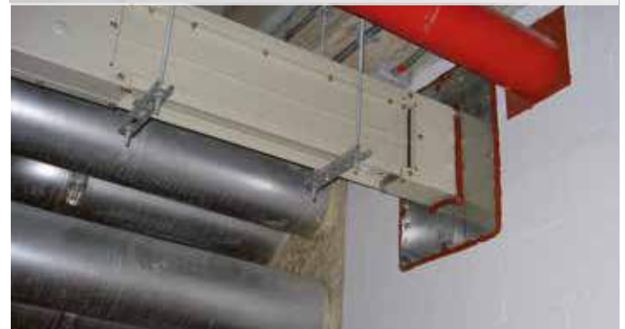
Nueva sede edificio Bancolombia. Medellín- Antioquia 2009 "Sellos cortafuego instalados en tuberías del sistema de red contra incendio, tuberías de aire acondicionado y elementos conductores de energía eléctrica."
