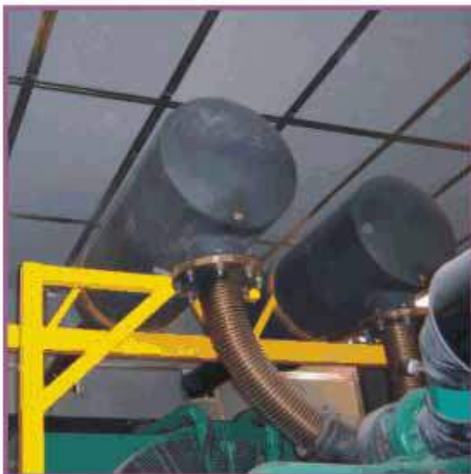
Silenciador del sistema de extracción de aire.
